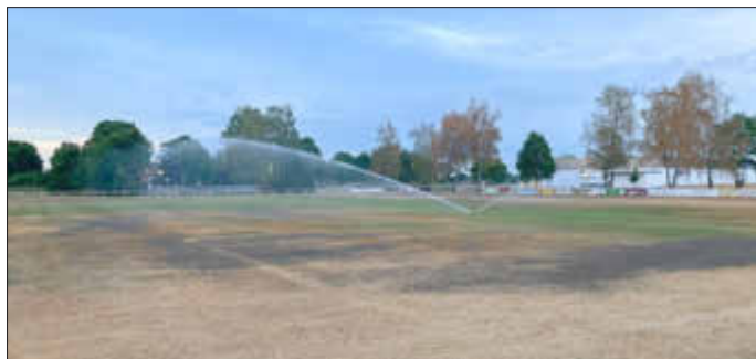
Die neue Beregnungsanlage auf dem Hauptfeld in Klosterlechfeld ist seit Kurzem im Einsatz. Foto: Matthias Ballatz
